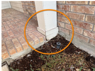
Wood rot/front column
