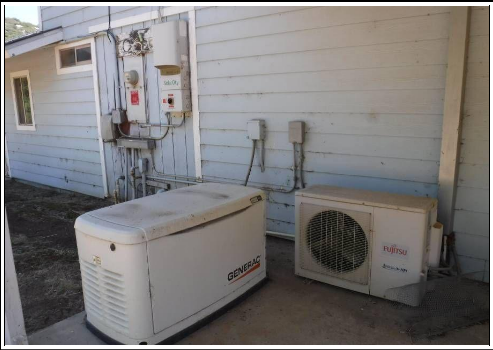
generator and mini split
