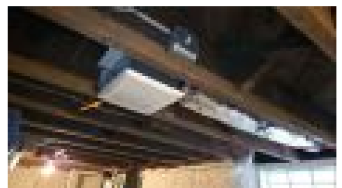
Basement Vent Fan
